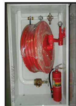
ตู้สายน้ำดับเพลิง (Fire Hose)
